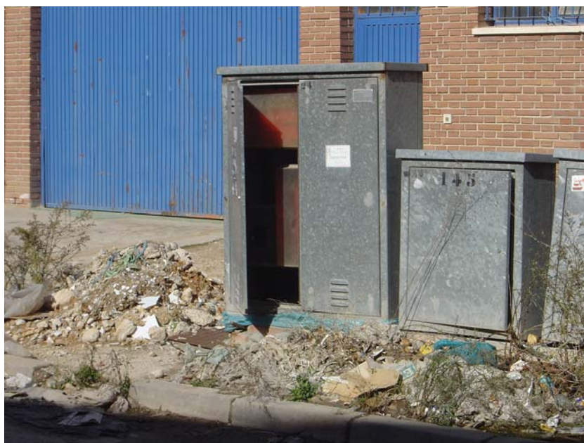
Estado en el que se encuentran los cuadros eléctricos que con tanto celo custodia el concejal de servicios
